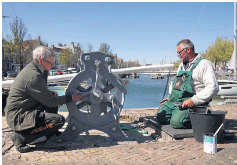
John Dijkstra en Monique Wolff werken aan de laatste van de vier compleet vernieuwde lieren, waarmee de sluisdeuren worden geopend en dichtgedraaid
